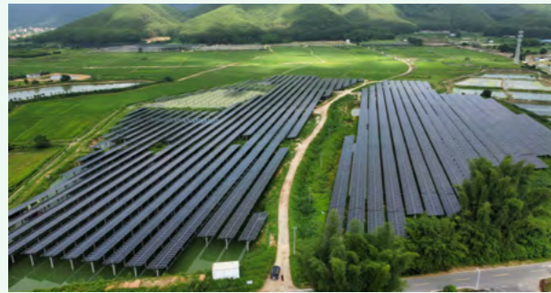
广东佛山水产养殖场“渔光互补”光伏电站项目
